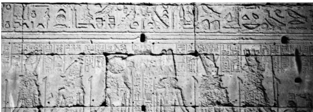
Abb. 11: Verankerungslöcher für die Metallkonstruktion unter dem Hathorkopf
