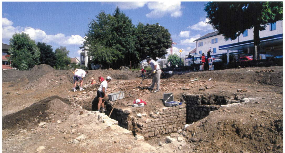
Abb. 6 Einsatz der Freiwilligen Bodenforscher im Keller K3 auf der Ausgrabung Laufen- burg-Schimmelrych.
