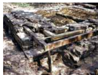
Mit modernen Kanthölzern rekonstruierter Balkenrost während der Grabung 1975. Der Einbau von Kant- und Rundhölzern diente dazu, den Turm während des Baus zu stabilisieren, was eine kürzere Bauzeit erlaubte.
